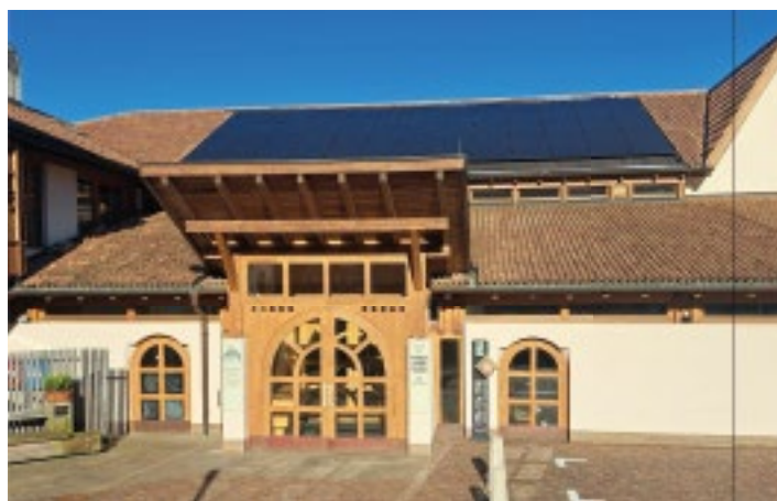
Una parte dell'impianto fotovoltaico sul tetto dell'edificio comunale
